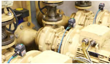
電動モーター + ポンプ
